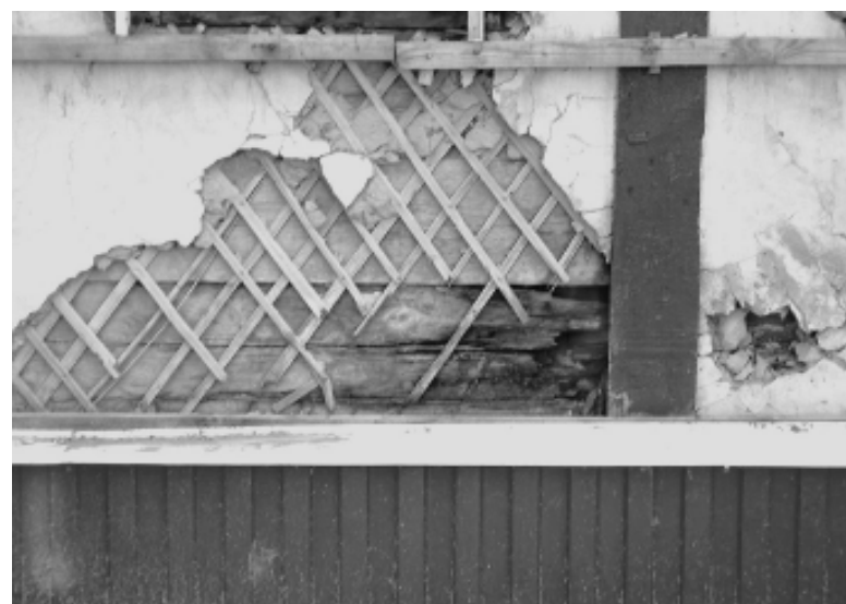
На снимке: когда жители одного из ветхих домов сняли после ремонта металлический лист, то обнаружили насквозь прогнившую стену.
