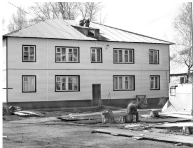
На снимке: металлический саркофаг лишь скрыл прогнившие стены, перекрытия и внутренние коммуникации ветхого дома, который может в любой момент рухнуть.
